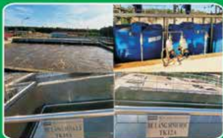
Hệ thống xử lý nước thải
